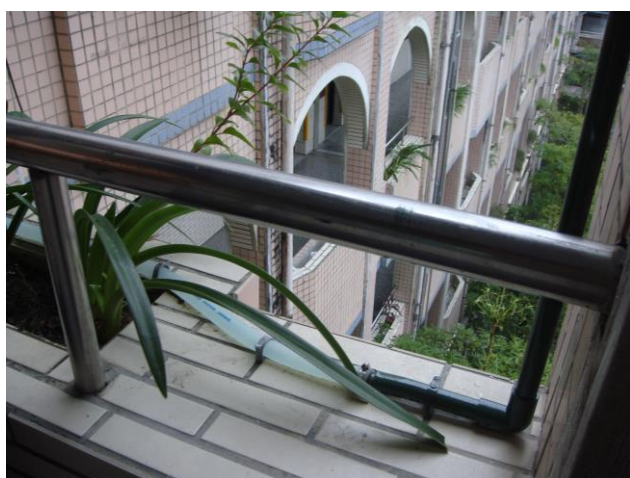
照片 3 說明：5 樓花台雨水回收澆灌系統。
