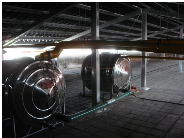
照片 2 說明：屋頂 2 噸雨水回收系統。
