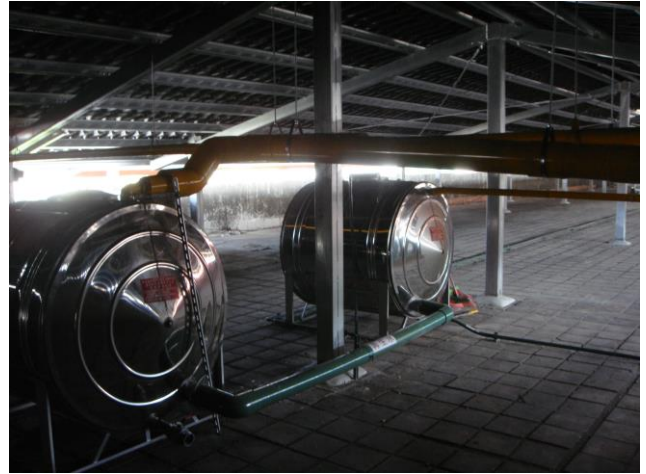
照片 2 說明：屋頂 2 噸雨水回收系統。
