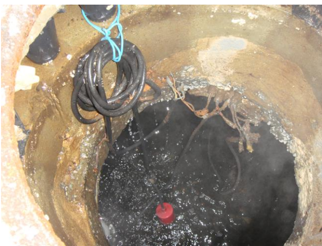
照片 5 說明：東昇樓地下室筏基水源。
