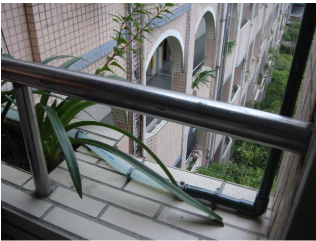
照片 3 說明：5 樓花台雨水回收澆灌系統。
